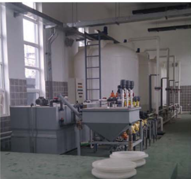
北京清河污水处理厂加药系统
