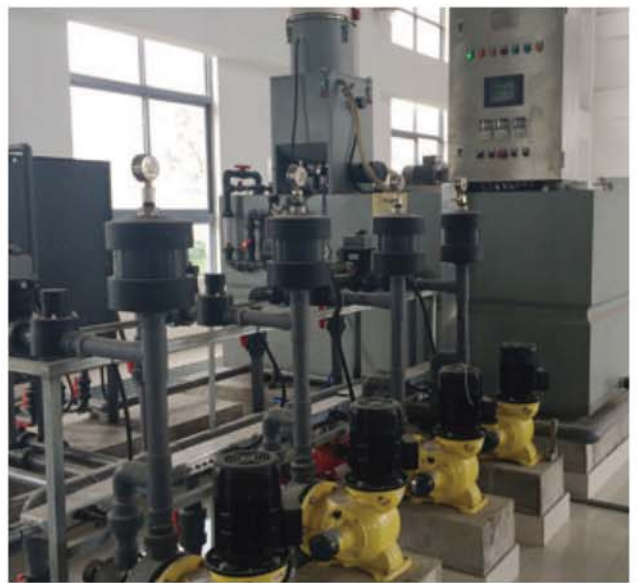
江南水务虞山污水处理厂 PAM 加药系统
