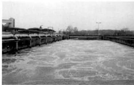
(b) 超声波设备在赛维塔尔污水厂投用后膨胀污泥消失
