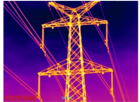
使用L07-236长焦镜头测试50米远高压塔线夹
