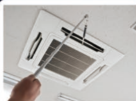
空调出风口测试
