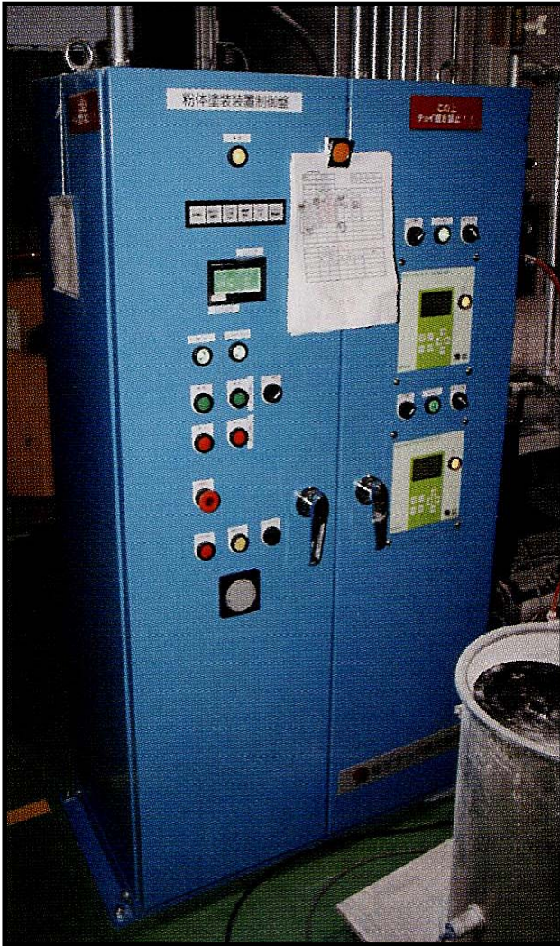
▲粉体塗装装置制御盤
