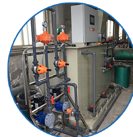
浙江某树脂工厂废水加药系统
