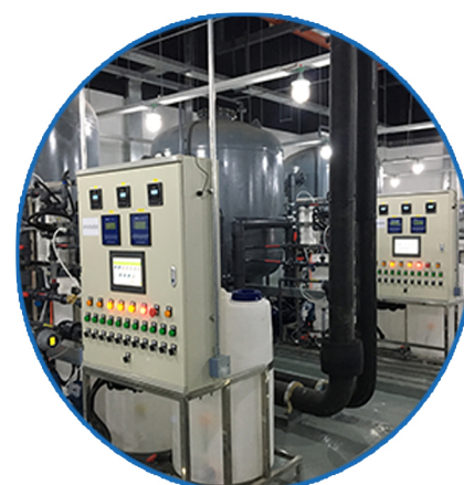
上海某数据中心冷却水加药系统
