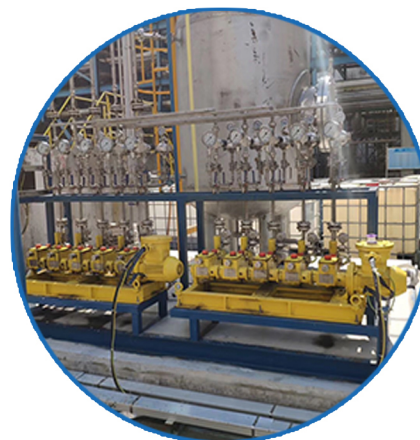
福建某化工厂药剂添加系统
