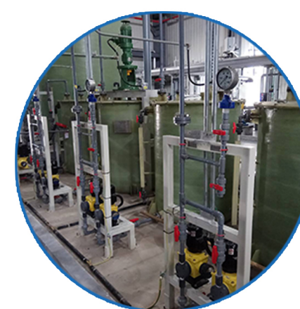
陕西某硅烷化工厂冷却水加药系统
