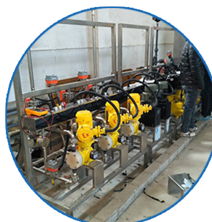
河南某火电厂冷却塔加药系统
