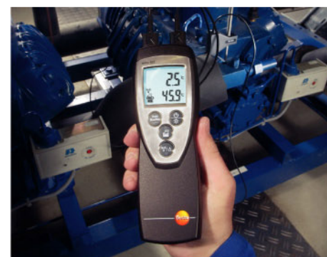
同时测量制冷设备中的过热和过冷
