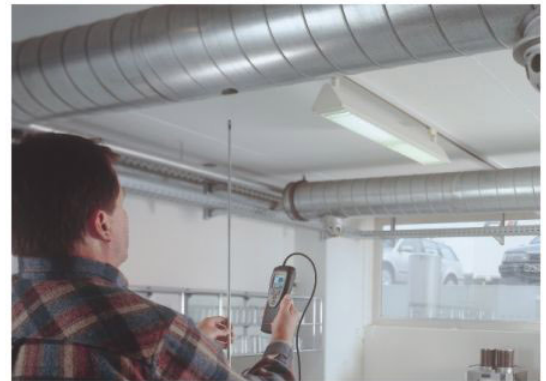
testo 425, 检测厨房的排风量
