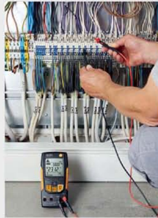
测量开关柜中的电压
