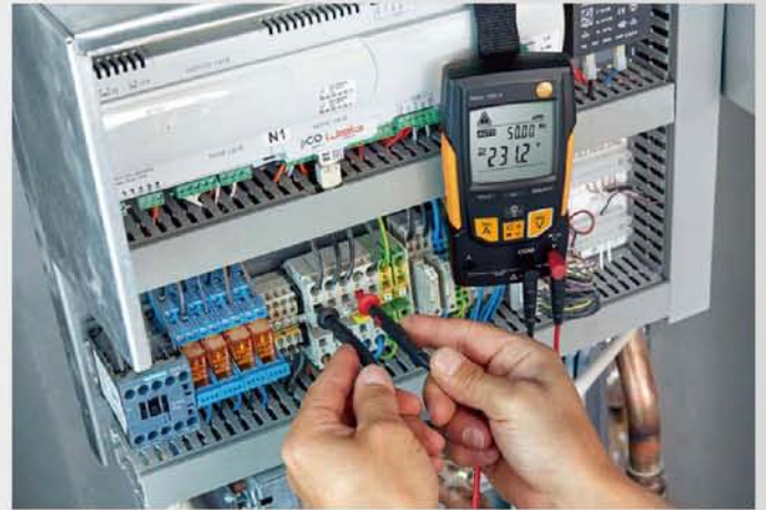
测量热泵开关盒中的电压
