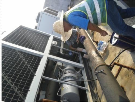
维保风冷冷水机组
