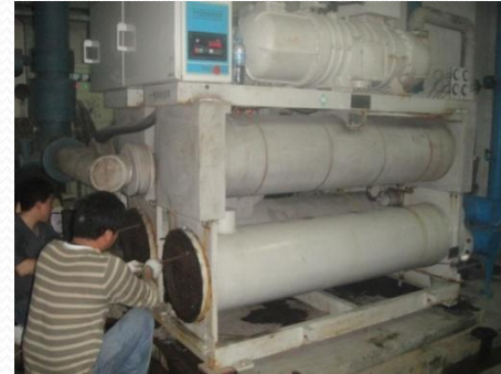
维保水冷冷水机组
