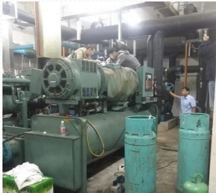
维保水冷冷水机组
